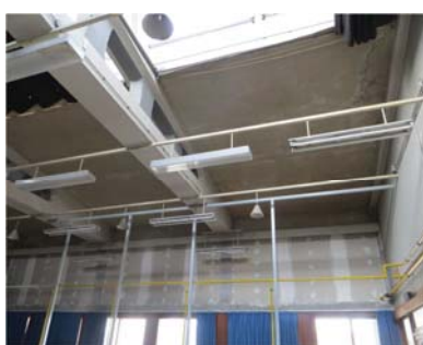
Plafonds avec flocage d'amiante
